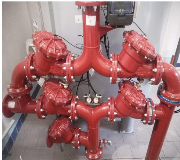
Armaturní uzel z pneumatických ventilů a elektronických klapek pro pískový filtr
