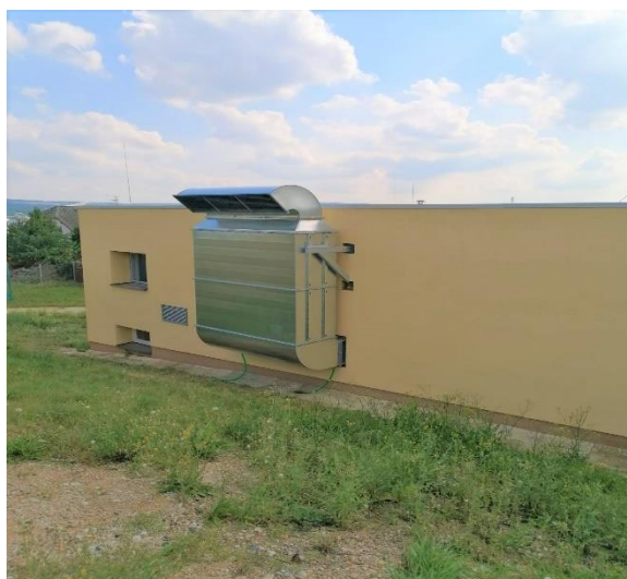
Nainstalovaný hlukový filtr
