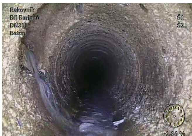
Neodborné a netěsné napojení do stokového potrubí
