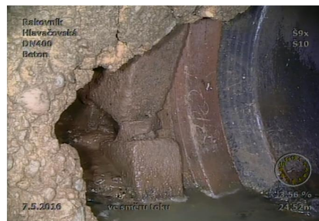
Detail se silnou degradací betonu
