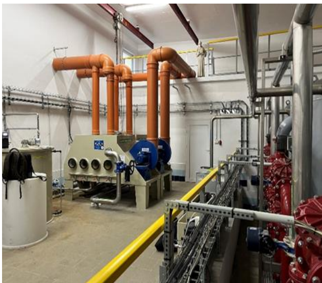
Technologie provzdušnění Bubla
