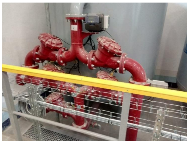
Armaturní uzel z pneumatických ventilů a el. klapek pro tlakový filtr
