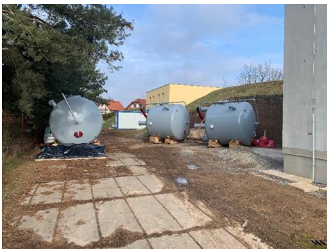
Tlakové filtry před instalací
