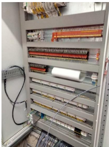
Část technologického rozvaděče
