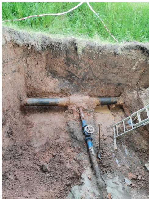
Původní vodovodní přípojka se dvěma místy opravy opravným pasem
