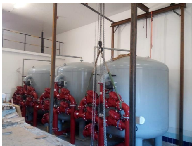
Tlakové filtry po instalaci
