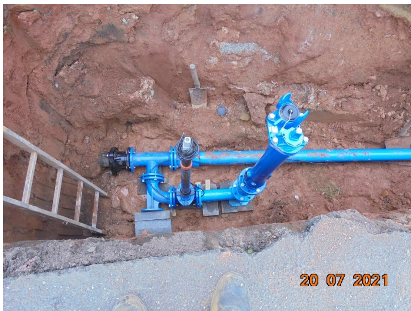
Usazení hydrantu a šoupěte
