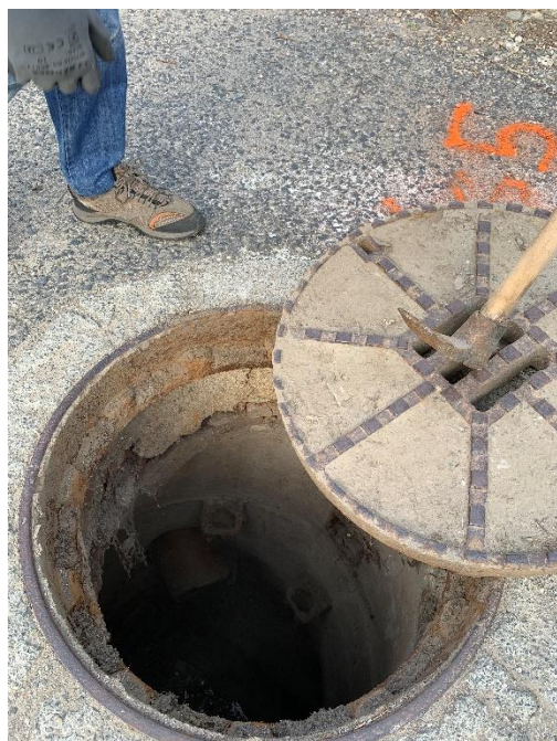
- kanalizační šachty před sanací; patrný rozpadlý kónus nebo vyzdívaný šachtový vstup
