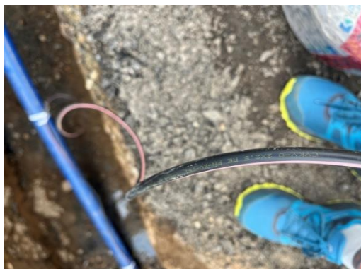
Signalizační vodič přidáváný k vodovodnímu potrubí
