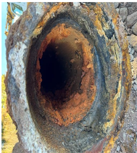
Řez původním potrubím se značnou inkrustací
