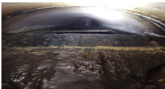
Průhled do průřezu stoky, kde v horní části je usazený materiál nánosů, vlivem čištění se vrstva nánosů propadá
