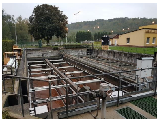
obr. 2.: Nové zmodernizované shrabovací linky
