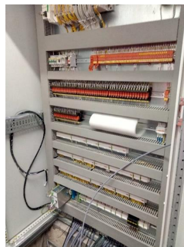
obr. 29.: Část technologického rozvaděče
