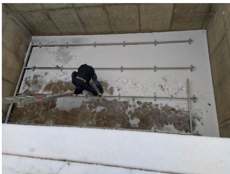
obr.: 16.: Aktivační nádrž s rozvody vzduchu
