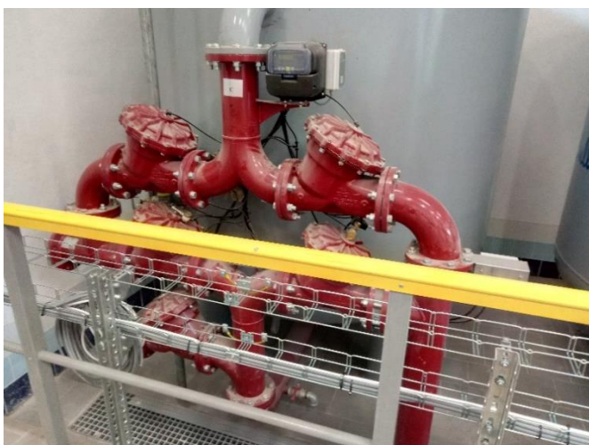
obr. 28.: Armaturní uzel z pneumatických ventilů a el. klapek pro tlakový filtr
