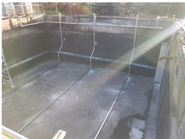
obr. 17.: Sanace akivační nádrže
