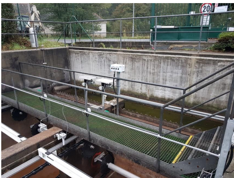
obr. 7.: El. instalace pro naklápěcí žlaby
