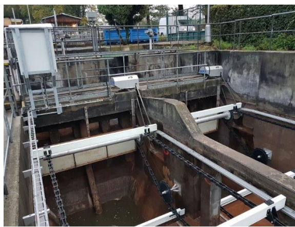
obr. 6.: Nový hnací pohon, hnací hřídel, plastový řetěz a el. instalace
