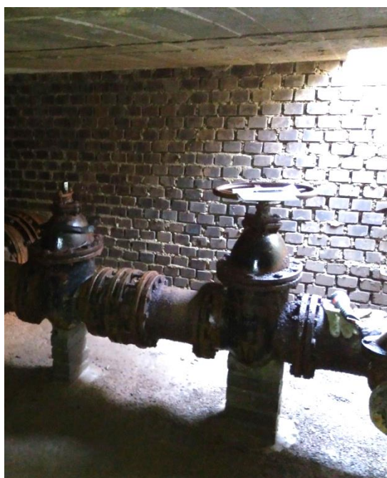
Větev „C“ před osazením průtokoměru
