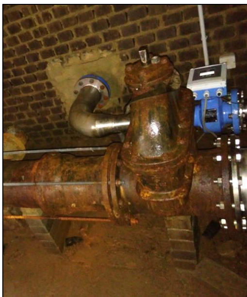
Větev „B“ před osazením průtokoměru
