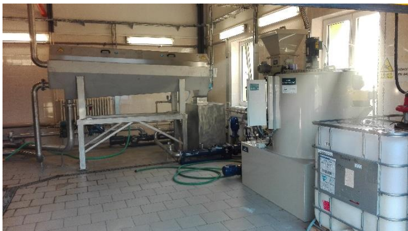
-nový stroj na zahuštění kalu, pohled vlevo na rotační zahušťovač s podpěrnou konstrukcí, po pravé straně stanice přípravy flokulantu s násypkou
