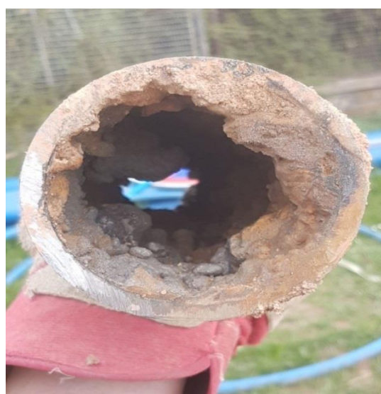
- příčný řez původním potrubím, zachycena inkrustace na vnitřní straně trubky
