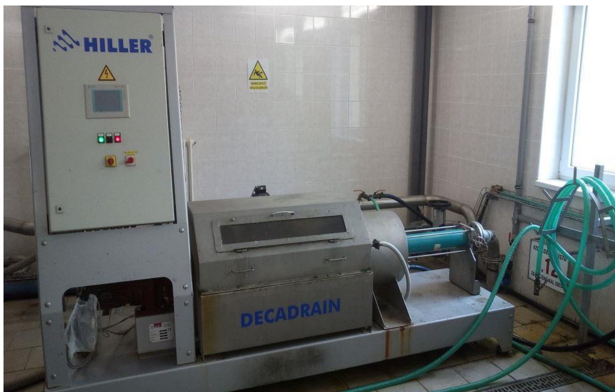
-původní stroj na zahuštění kalu
