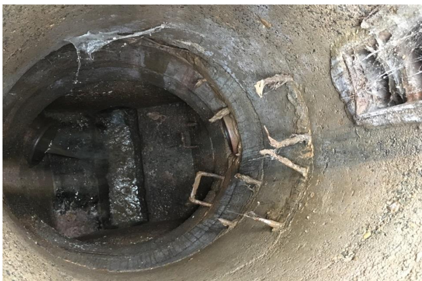
- pohled do revizní šachty kanalizace před sanací, poškozené a chybějící stupačky na stěně šachty, přesahující potrubí ve dně
