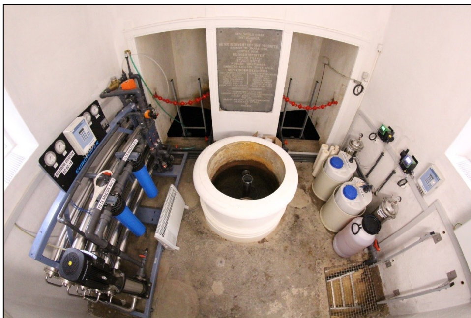
Úpravna vody v objektu zemního vodojemu Jesenice „Horní“
