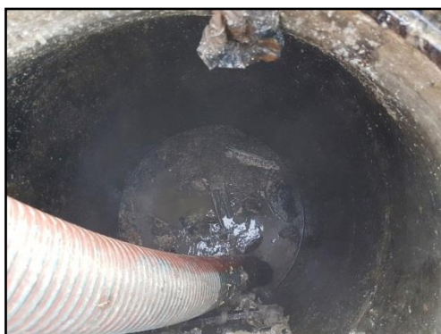
Obr. ucpaná kanalizační šachta
