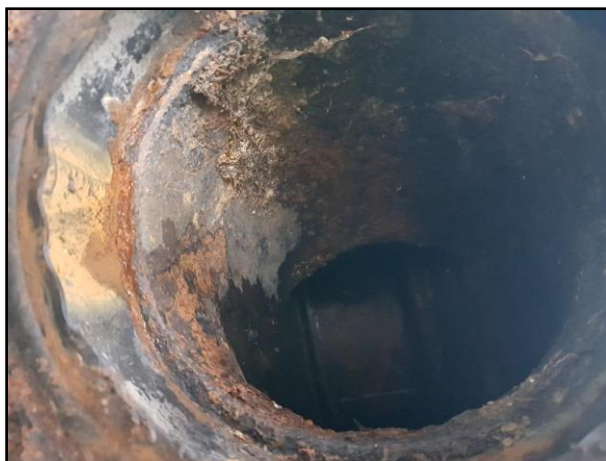
Obr. koroze čerpadla
