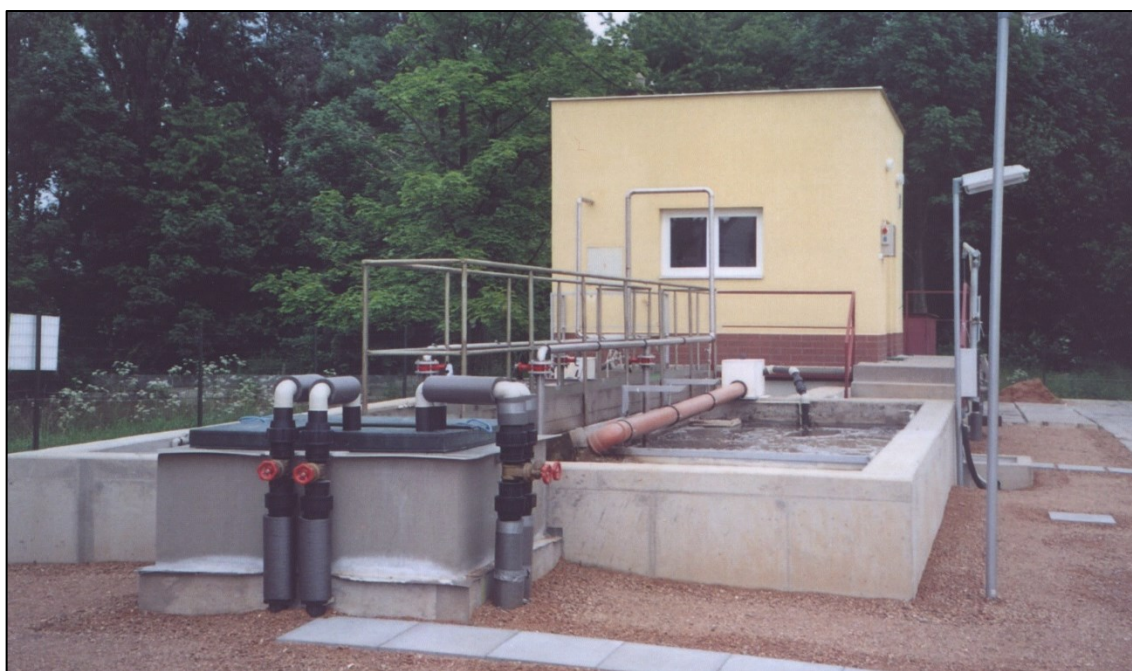
Čistírna odpadních vod Pavlíkov
